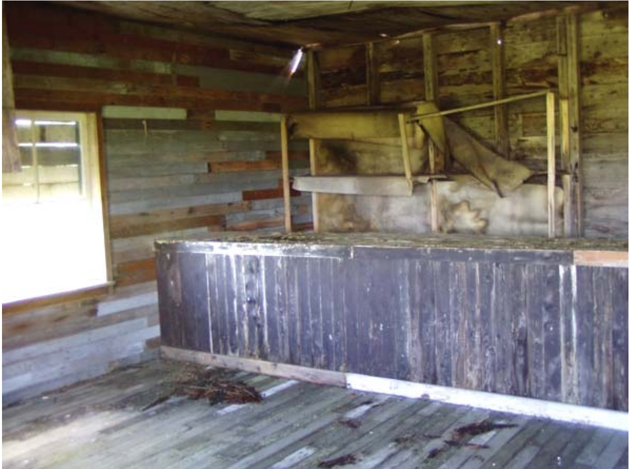
Figure SA034 : Intérieur de la maison 4, comptoir et tablette de rangement, la structure est fortement endommagée, site George Papps (HaGa-1, UMI-83).
