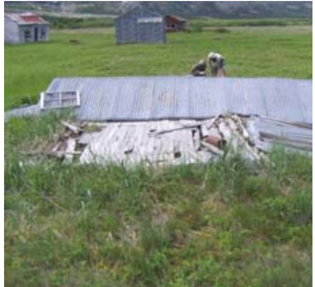
Figure SA028 : Maison 1, toit effondré perpendiculairement au plancher, site George Papps (HaGa-1, UMI-83), vue vers le sud-ouest
